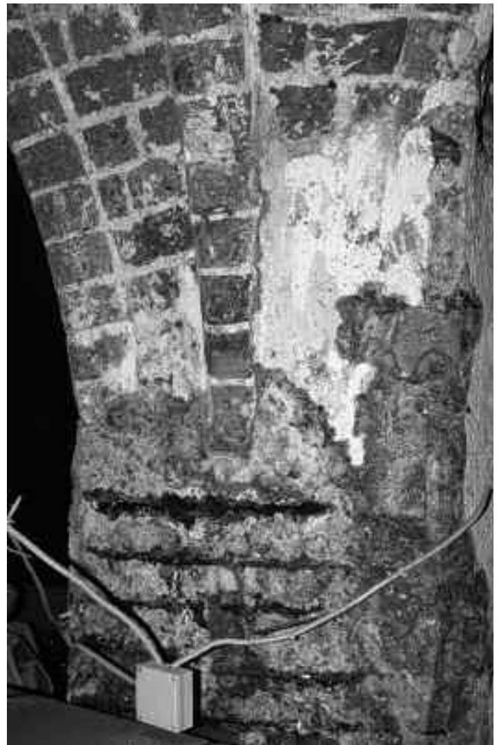
Keller Schüsselbuden 2: Mit Eisenbeton-Ummantelung wollte man die Backsteinpfeiler vor 40 Jahren „sichern“ – eine bauphysikalische Dummheit mit schlimmen Folgen
