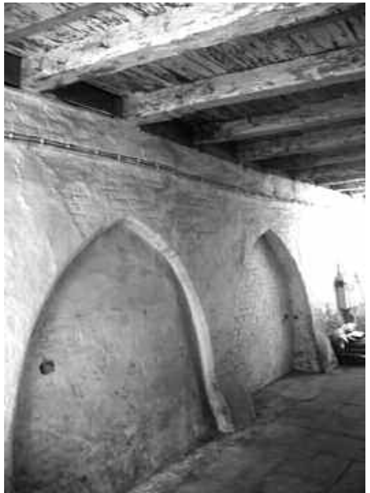
Fleischhauerstraße 79. Die „klassische Diele“ der Jahre um 1290/1300, mit einer Brandwand, der eine spitzbogige Arkatur wie eine Brücke vorgesetzt zu sein scheint. Auf dem Rücksprung dieser „Brücke“ liegen die Balken auf. Wirkt sehr repräsentativ und war auch so gedacht. Man konnte damit zwar Steine sparen, aber der Aufwand für die Bogen-Lehren und die Fasen-Formsteine wiegt die Ersparnis bei weitem auf. Was wurde auf dieser Diele gemacht, wozu diente sie? Ein Fleischhauer-Haus, in dem kein Fleisch „gehauen“ wurde, die Tiere wurden ja in den „Küterhäusern“ unten an der Wakenitz geschlachtet und zerlegt. Nicht mal Fleisch verkaufen durfte man hier, dazu waren die Fleischbänke oben auf dem Schranken da.
