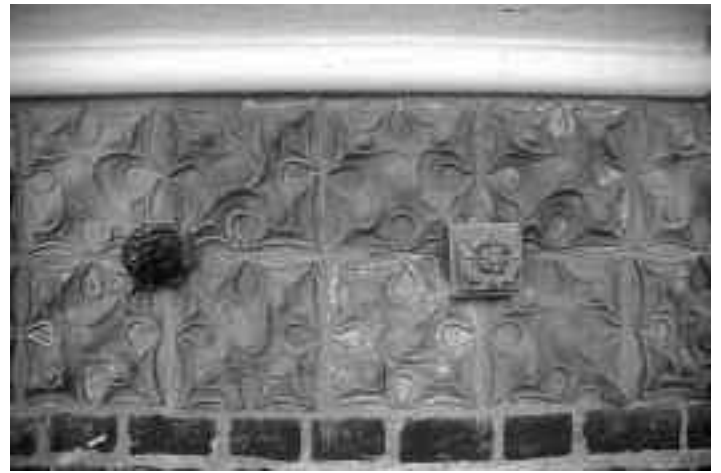
Holstentor, Stadtseite. Detail aus dem Terrakottafries unter dem 2. Obergeschoss. Vier Formstücke bilden eine Einheit, die durch die mittig aufgesetzte „Blume“ deutlich wird. Motiv hier eine lappige Plattform, die entfernt an spätgotisches Maßwerk erinnert. Die untere Form in der Mitte ist original und trägt Reste eines farbigen Überzugs
