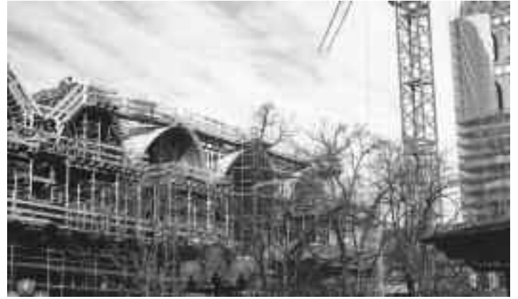
Betonschalen-Guss per Eimer und mit der Hand, wie bei den Römern. Technik
