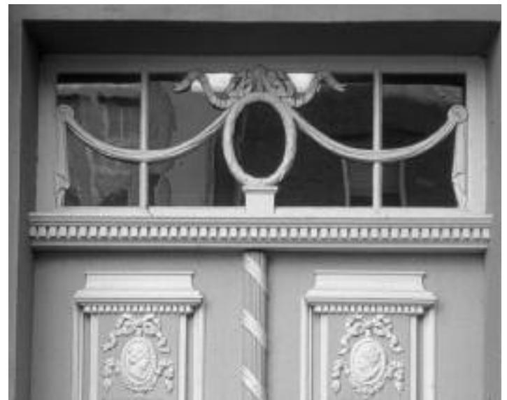
6 Früher Beckergrube 29, jetzt Depot St. Annenmuseum Die schon vor dem Krieg in Museumsbesitz gelungene Tür war über Jahre hinaus die Eingangstür zum St. Annenmuseum und führte ins südliche Seitenschiff der einstigen Annenkirche mit dem Kassenbereich. Mit Einbau der Kunsthalle in die Kirchenruine 2002/03 wurde die Tür gegen ein großflächiges Stahl-Glas-Element ausgetauscht. – In der Mitte des Oberlichts das per Schleife aufgehängte Medaillon. Aus der Schleife schwingen sich die schmalen seitlichen Tuch-Girlanden heraus und bilden die stabilisierenden Holzsprossen der Glasflächen.
